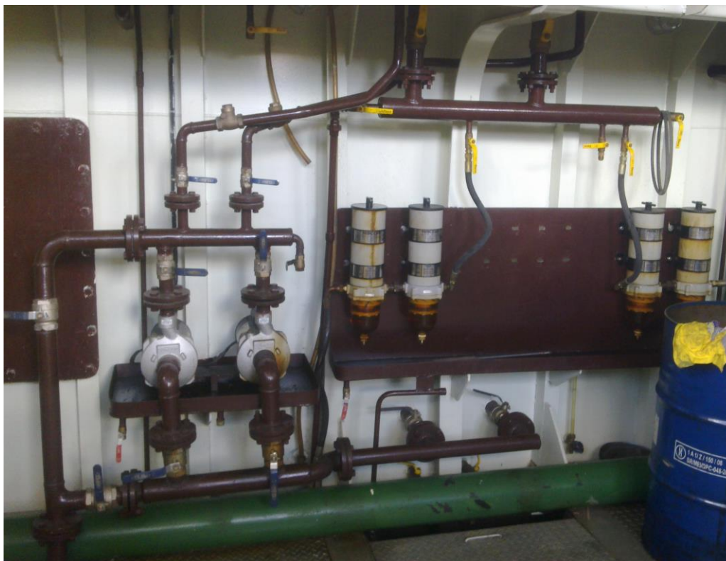
Figura 14 - Bombas de Transferência de óleo diesel
